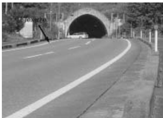
写真 1 小平尾断層による国道 352 号線の変位。
