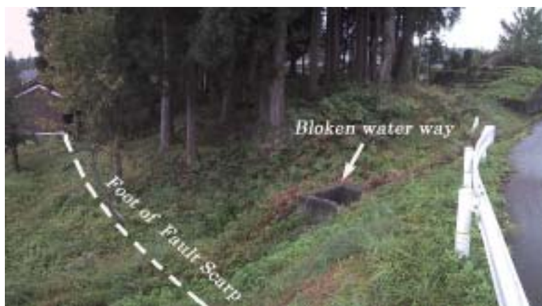
写真 2 小平尾断層の撓曲崖と、断層運動により破壊された排水路。
