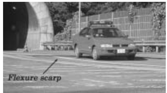
写真 4 下倉トンネル入り口付近の撓曲変位（六日町盆地西縁断層）。
