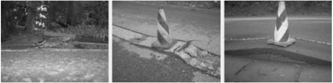
写真 3 路上の座屈変形（小平尾断層）.
