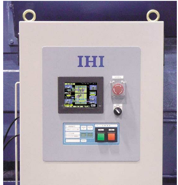
第 11 図 制御盤盤面 Fig. 11 Control panel
