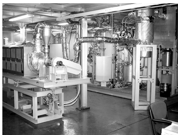
第 2 図 実証試験装置の概観 Fig. 2 Demonstration equipment
