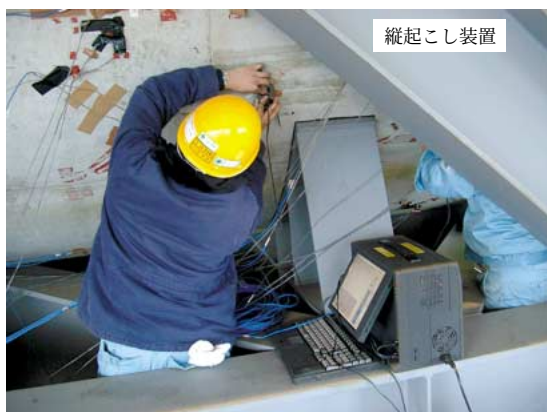
第 12 図 ひび割れ深さの測定状況 Fig. 12 Measurement operation
