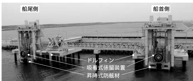
第6図 自動係留装置の全景 Fig. 6 Automatic mooring system
