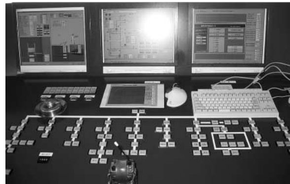
第12図 浚渫操作盤 Fig. 12 Dredging control panel
