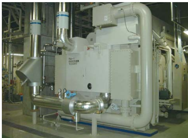
第 7 図 蒸気吸収式冷凍機 Fig. 7 Steam effect absorption chiller
