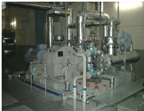
第 4 図 背圧式蒸気タービン発電機 Fig. 4 Back pressure turbine power generator
