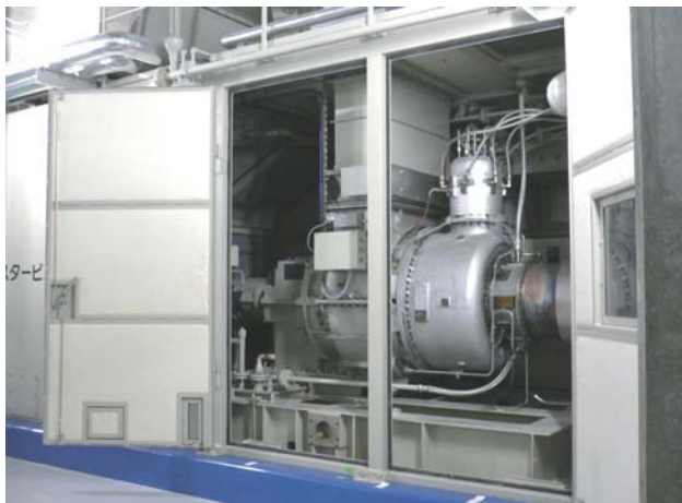
第 3 図 ガスタービン発電機 Fig. 3 Gas turbine power generator
