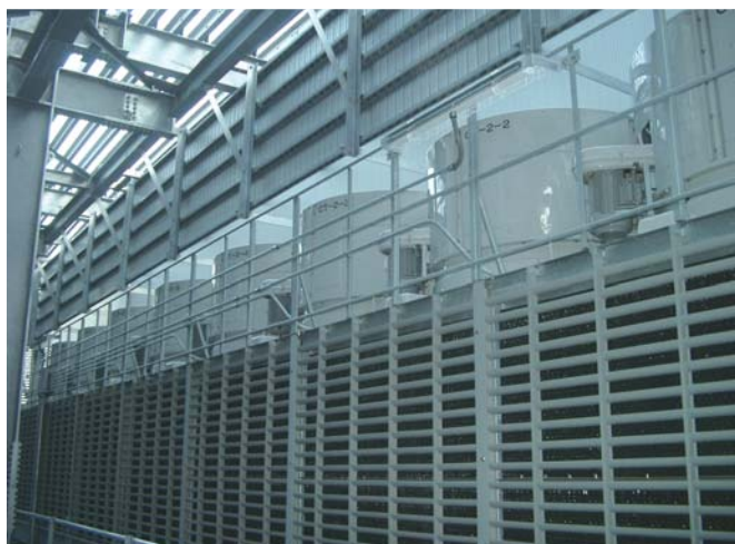
第9図 冷却塔 Fig. 9 Cooling tower
