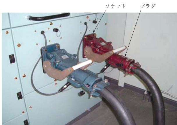
第5図 受電盤接続部のプラグ、ソケット Fig. 5 AMP plug and socket on shore connection panel
