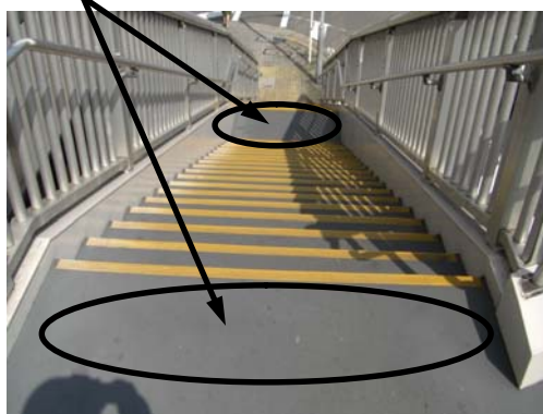
歩道橋下り口及び踊り場の点状ブロックの未設置箇所
