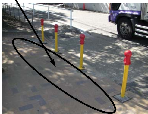
公園出入口の点状ブロックの未設置箇所
