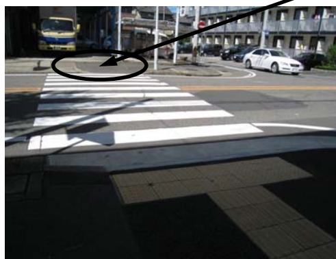
視覚障害者誘導用ブロックの未設置箇所
