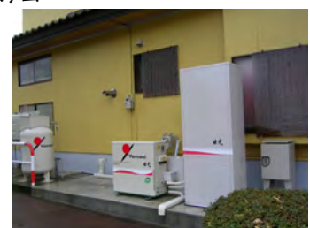
燃料電池システム
