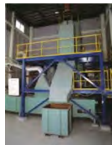
破碎・選別設備
