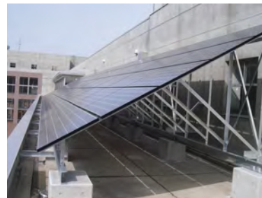
太陽光発電システム
