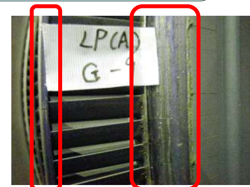
動翼と静翼の接触状況(動翼側)
