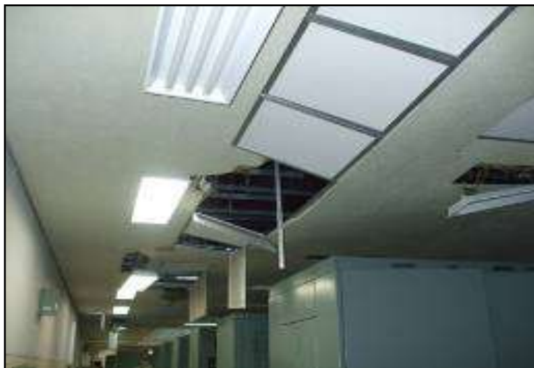
1号中央制御室:天井化粧板の脱落
