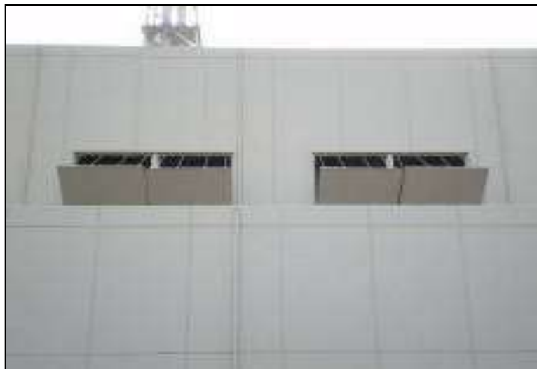
3号タービン建屋:ブローアウトパネル外れ
