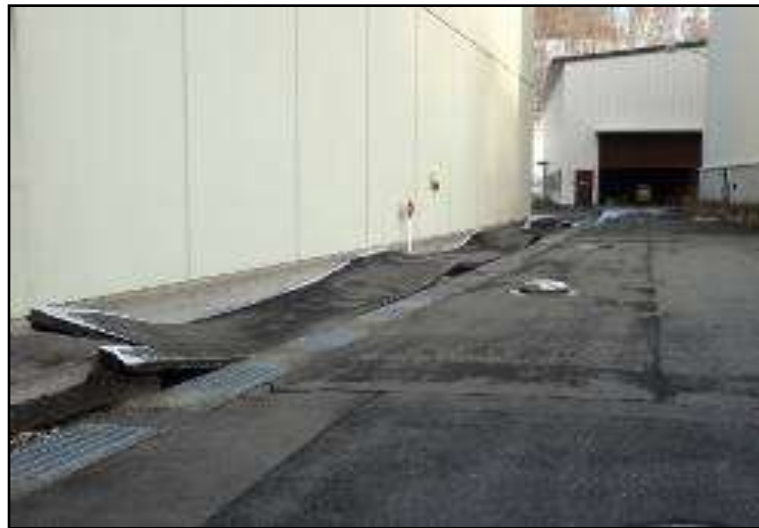
構内:舗装道路陥没
