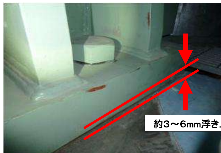
中間軸受台の浮き上がり(B部)
