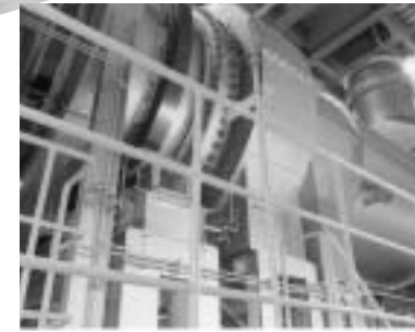
炭化炉（全連続燃焼方式）
