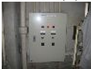
空気圧縮機制御盤
