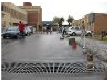
病院周辺の雨水排水設備
