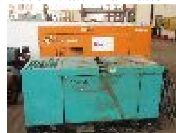
本案件による発電機（奥）バックアップとして待機中）
