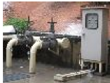
雨水排水ポンプ / オイルタンク の予備水槽への転換
