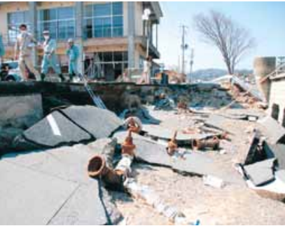
久之浜の陸機橋では、津波により損壊した水道管がむき出しに(4月14日)
