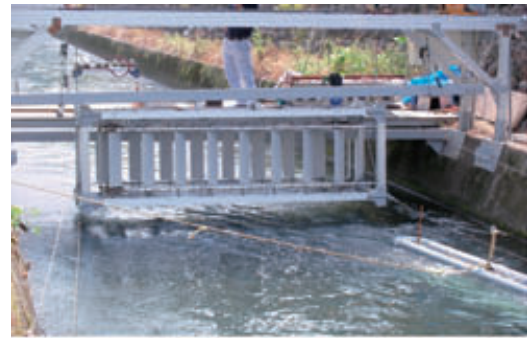
図2 上流から見た設置状況 (試験機の回転軸は4軸)
