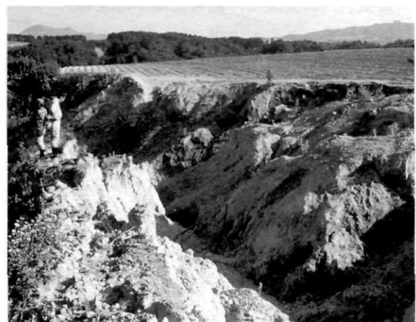
写真-2 ガリー侵食状崩壊タイプ
