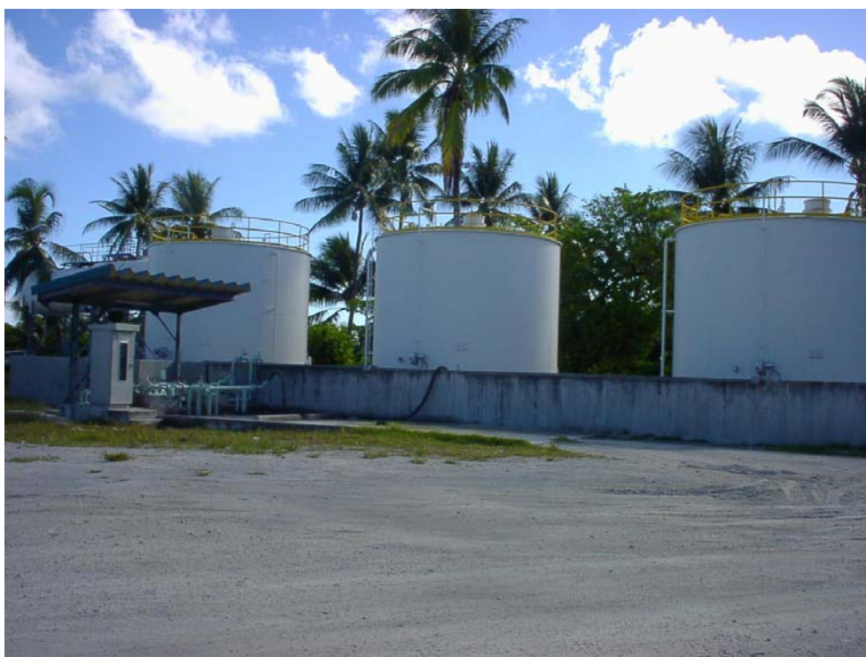
発電用油タンク
