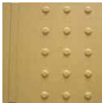
ホーム縁端警告ブロック
