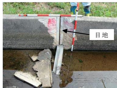
(a)コンクリートの剥落
