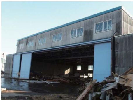
被災後の格納庫（正面）
