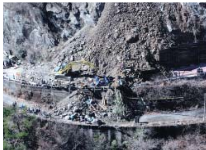
土砂崩れ現場
