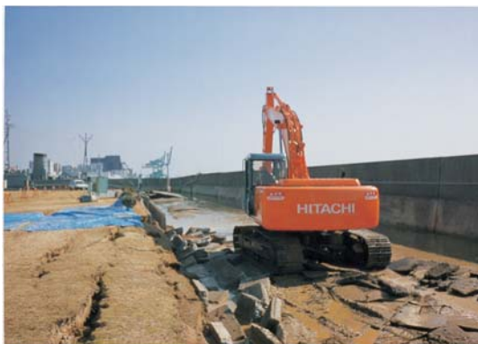
多数の亀裂が入った阪神基地隊の岸壁 (提供：朝雲新聞社)
