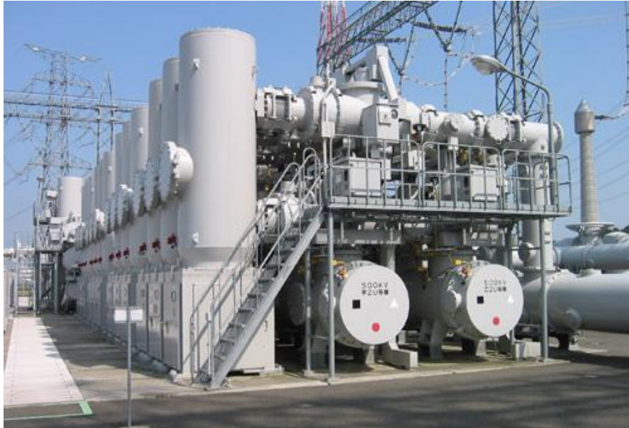
550kVガス絶縁開閉装置(GIS)
