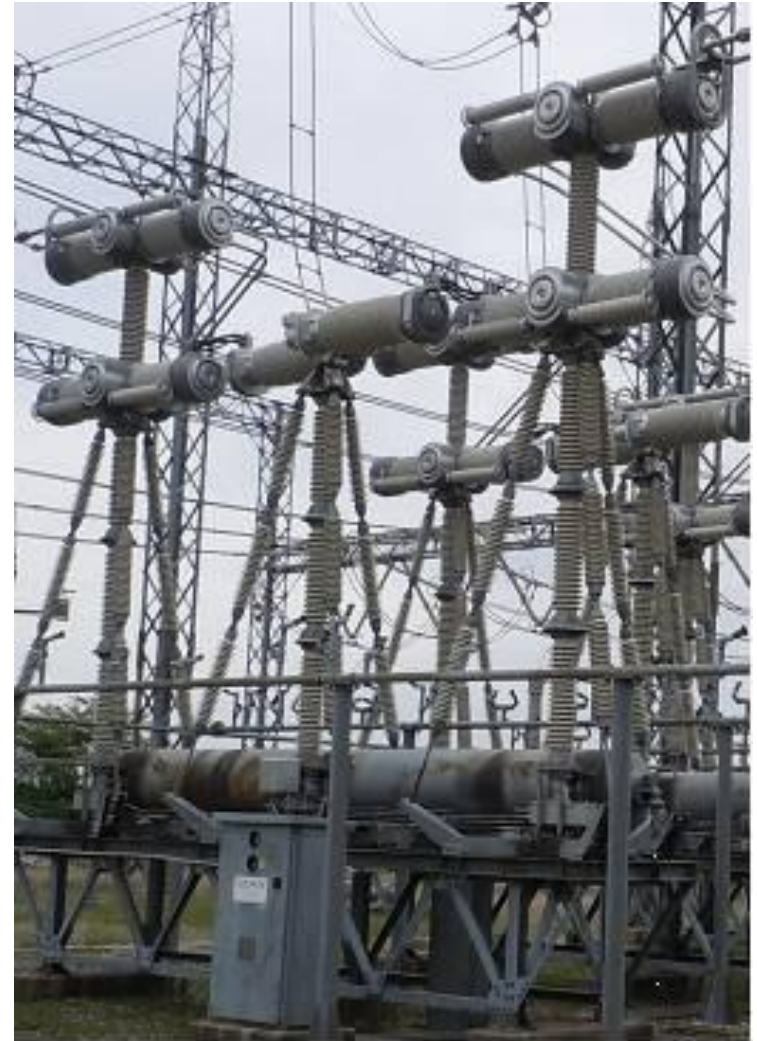
275kV空気遮断器(ABB)
