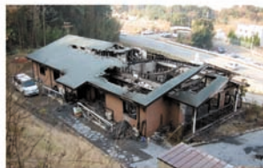
火災発生後の外観
