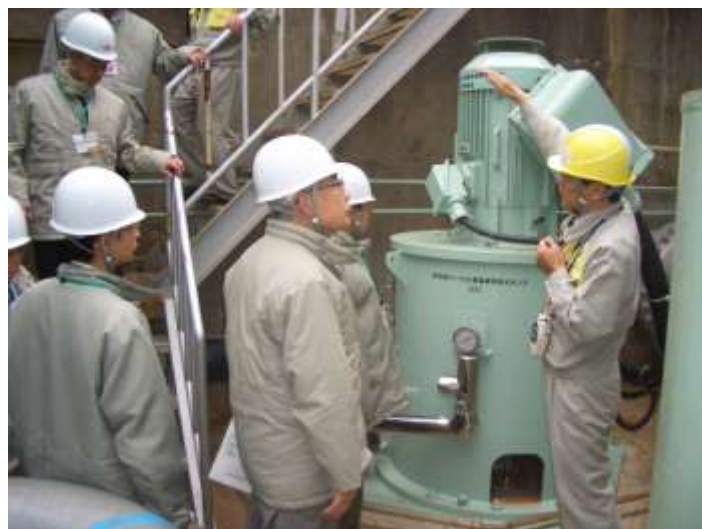
地震影響調査（北側ポンプエリア）
