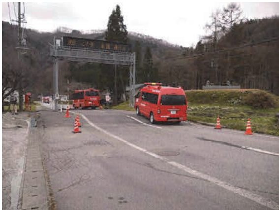
図-5 大出地点 国道 406 号に生じた断層変位
