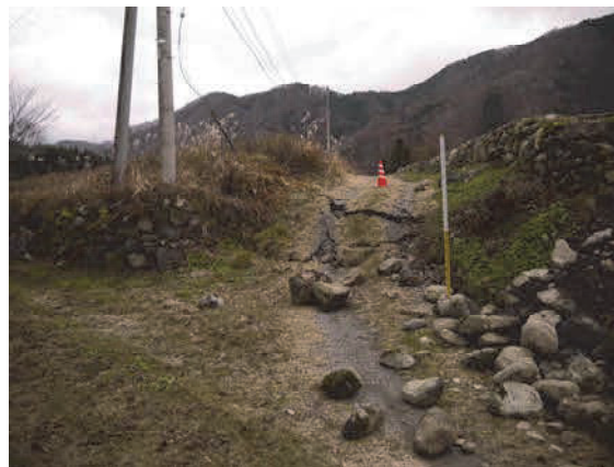
図-4 大出地点 逆向き崖を成長させる変状
