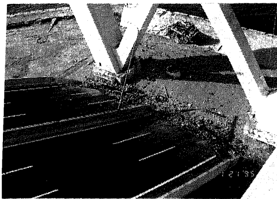
写真4 西宮港大橋橋脚周辺の地盤変状
