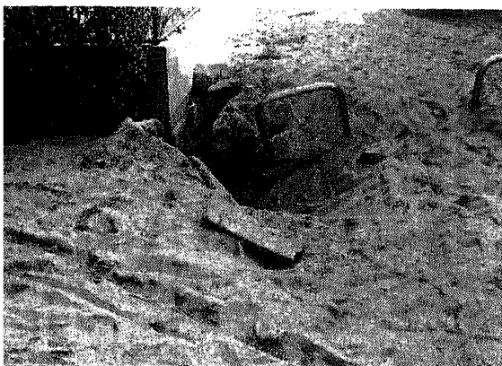
写真5 芦屋浜における液状化
