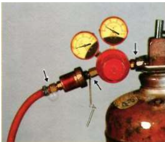
容器周辺の接続部
