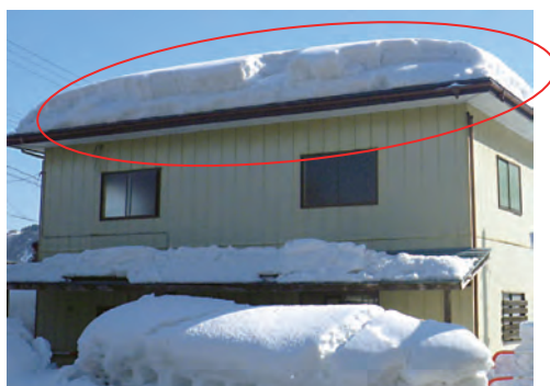
図3 長野県北部地震による屋根雪の落下状況(新潟県津南町)
