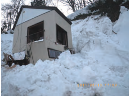
図8 地震による雪崩によって被災した建物 (新潟県十日町市)
