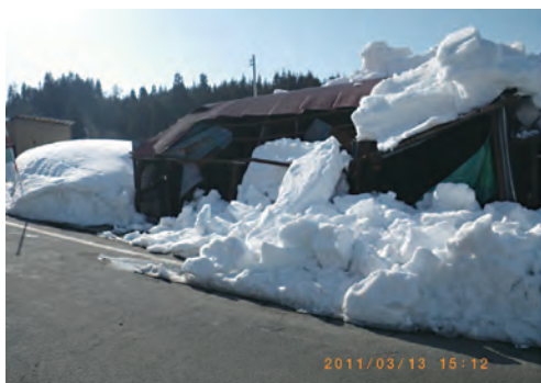
図2 長野県北部地震で屋根雪が崩落し、被災した倉庫(長野県栄村)
