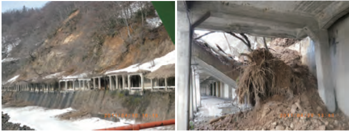
図13 背後の斜面の表層崩壊によるスノーシェットの崩壊 (長野県栄村横倉) Fig.13 Collapse of snow shed by seismicity-induced surface slide.
